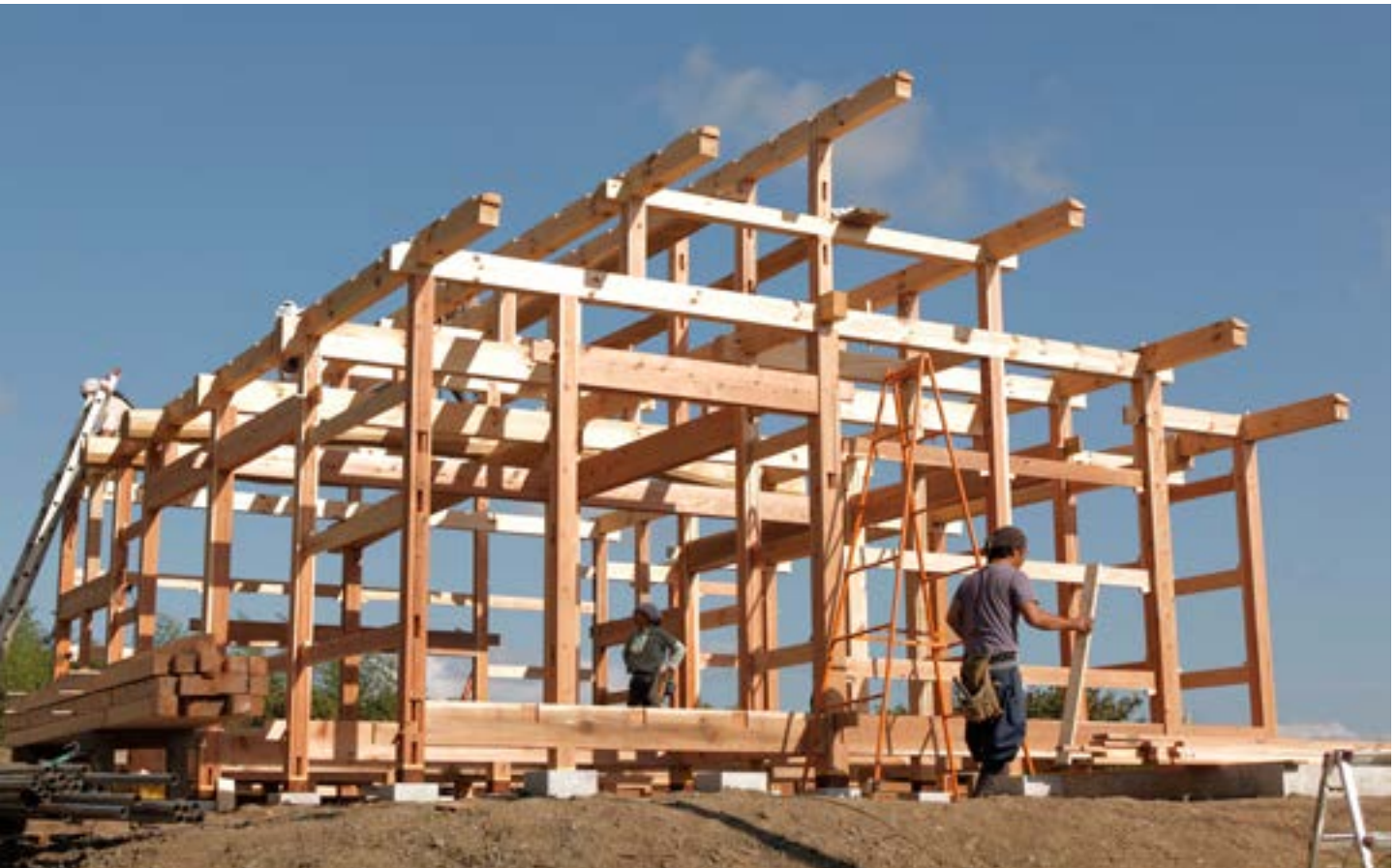
Framework of the main body of the Kamogawa House | Entramado del cuerpo principal de la Casa Kamogawa | Armação do corpo principal da Casa Kamogawa (Ken Kusakari)
