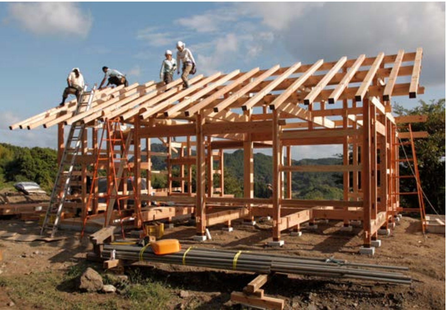
Assembly of rafters on the Kamogawa House | Montaje de pares en la Casa Kamogawa | Montagem dos caibros na Casa Kamogawa (Ken Kusakari)
