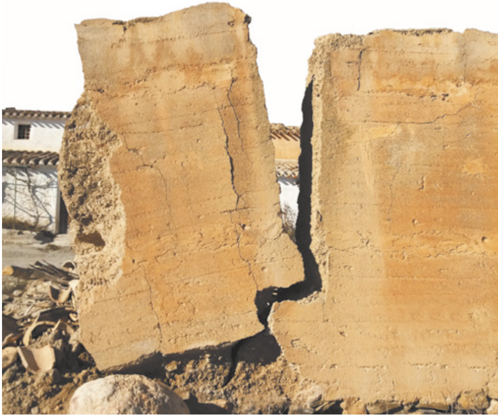
Muro de tapia en un estado previo al colapso en un cortijo de Almería
