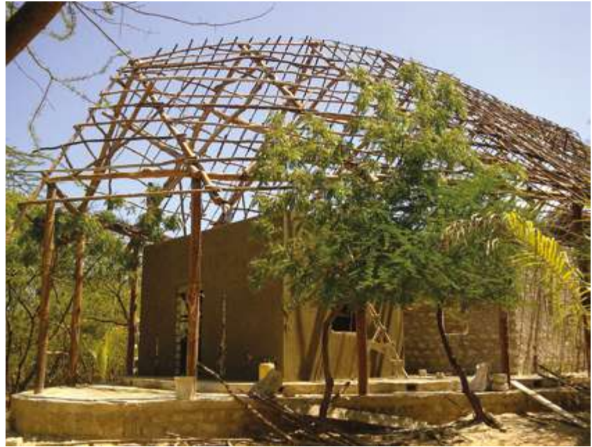
Makuti wooden structure during construction | Estructura de madera de makuti durante la construcción | Estrutura de madeira de makuti durante a construção
